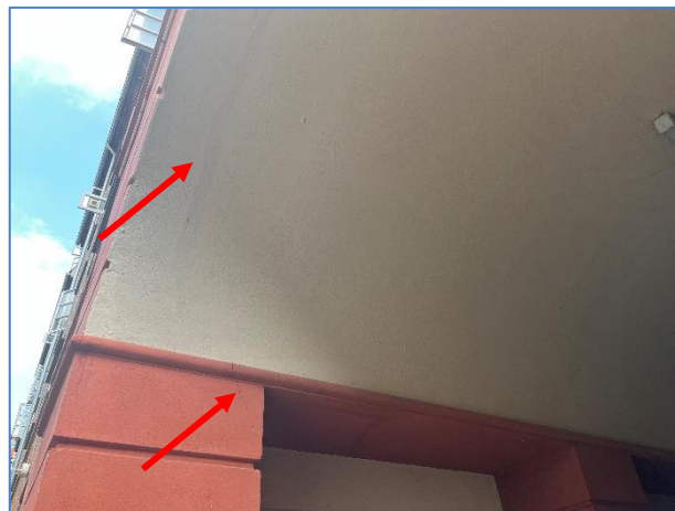
Foto 2: Væg/loft i portgennemgang
