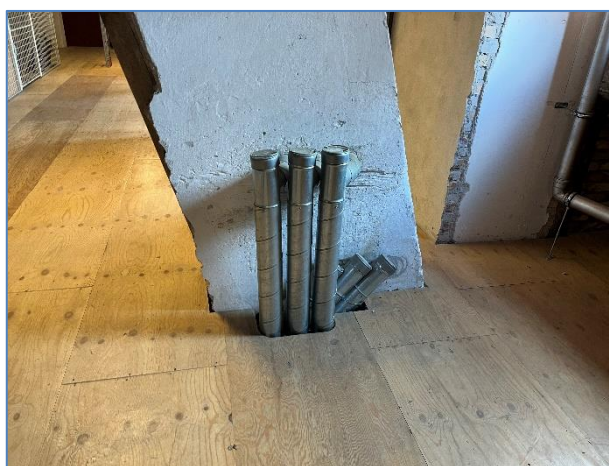
Foto 6: Ventilationskanaler på loft
