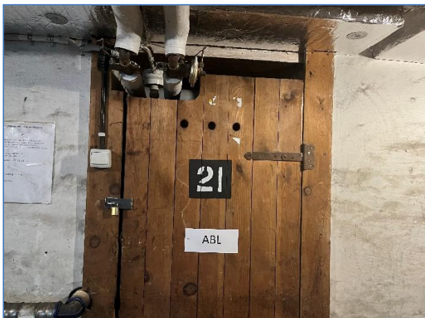
Foto 1: Træværk i kælder
