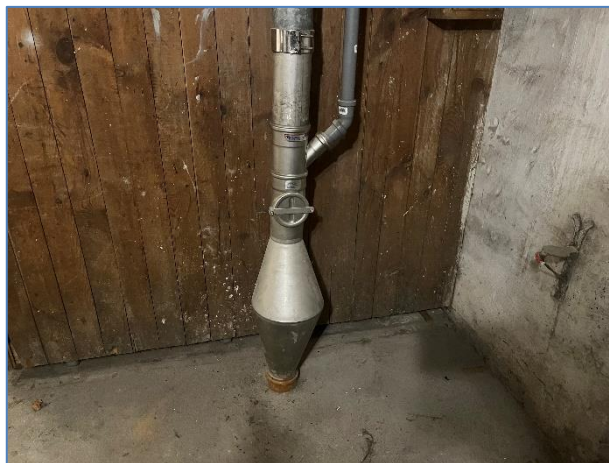
Foto 2: Afløb i kælder
