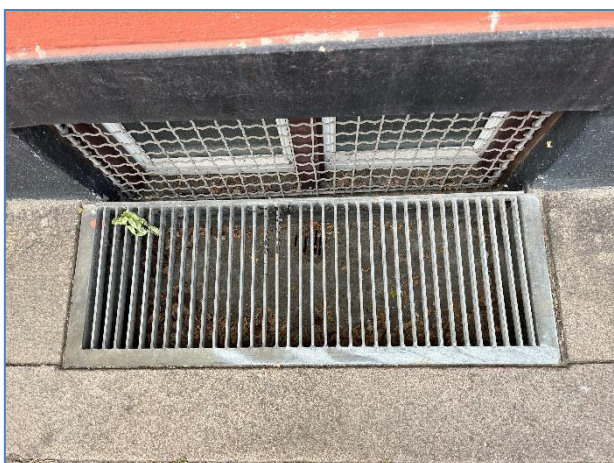
Foto 3: Lyskasse med afløb
