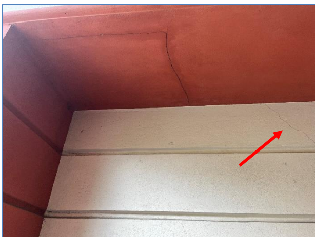
Foto 3: Væg/loft i portgennemgang
