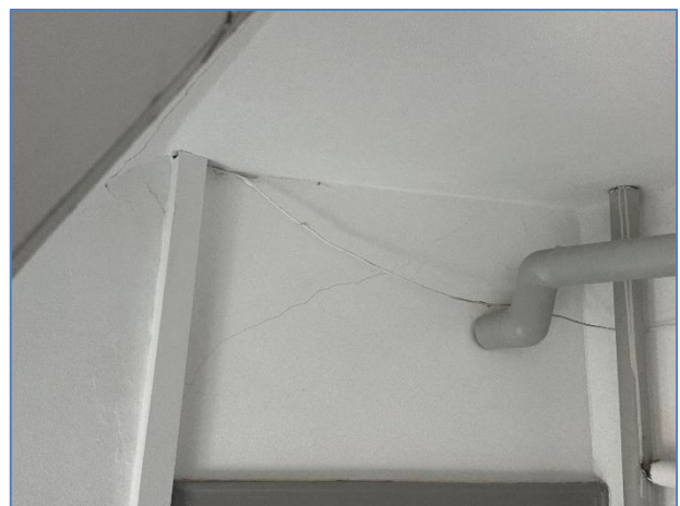
Foto 6: Vægge ved bagtrappe
