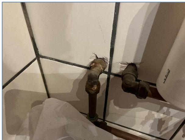
Foto 2: Rør i badeværelse
